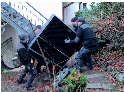
Die Wärmepumpe kommt. (Foto: Joachim Schmidt)
